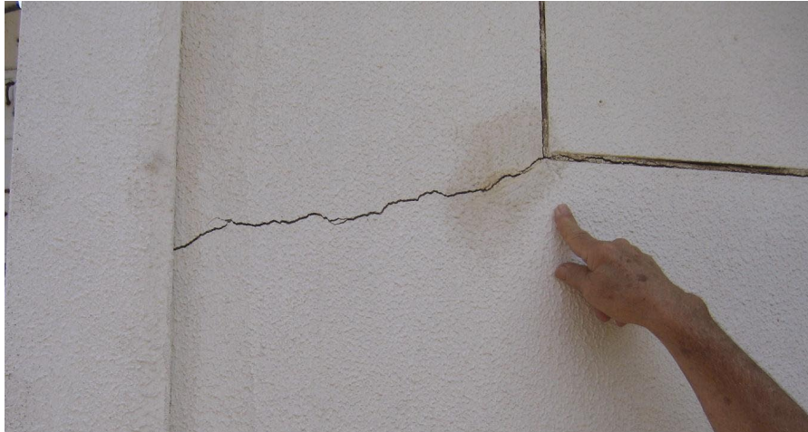
תמונה מס' 3: סדק במעטפת חיצונית של בית בשכונת נחל בקע בכאר שבע
