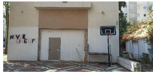
חצר הסניף במצב תחזוקה לא טוב, פסולת וציוד מפוזרים, צמחייה שאינה גזומה ואבני חיפוי חסרות בגדר.
