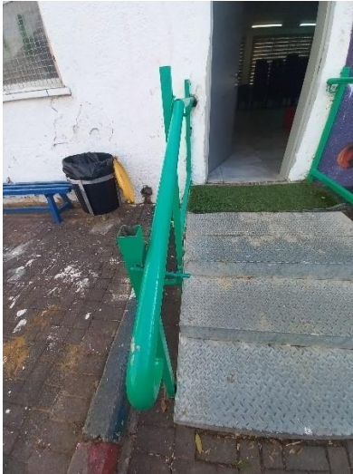
מדרגות הכניסה למבנה הסניף וזיזי מתכת הבולטים מהמעקה.
