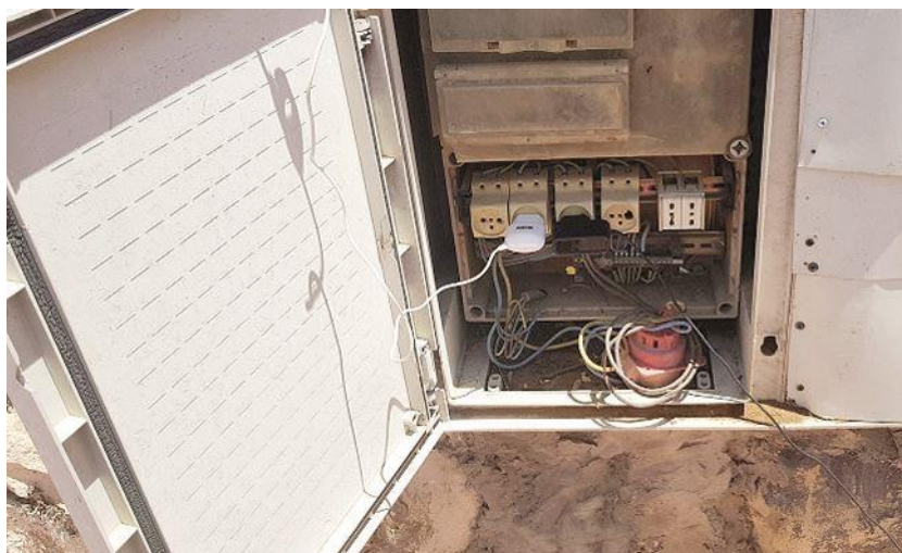
תמונה 3: מתקן חשמל לא בטיחותי
