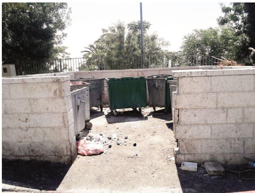
תמונה 17: מתקן אצירת אשפה בחניון הר ציון
